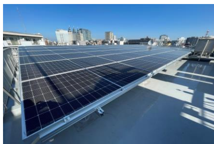
太陽光パネル
