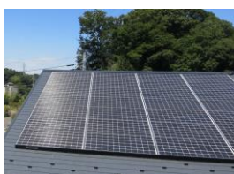
太陽光パネル
