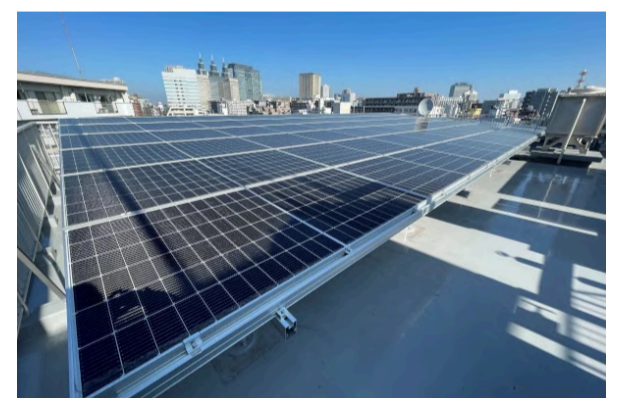
屋上に設置した太陽光パネル
