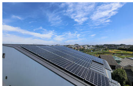
太陽光発電システム
