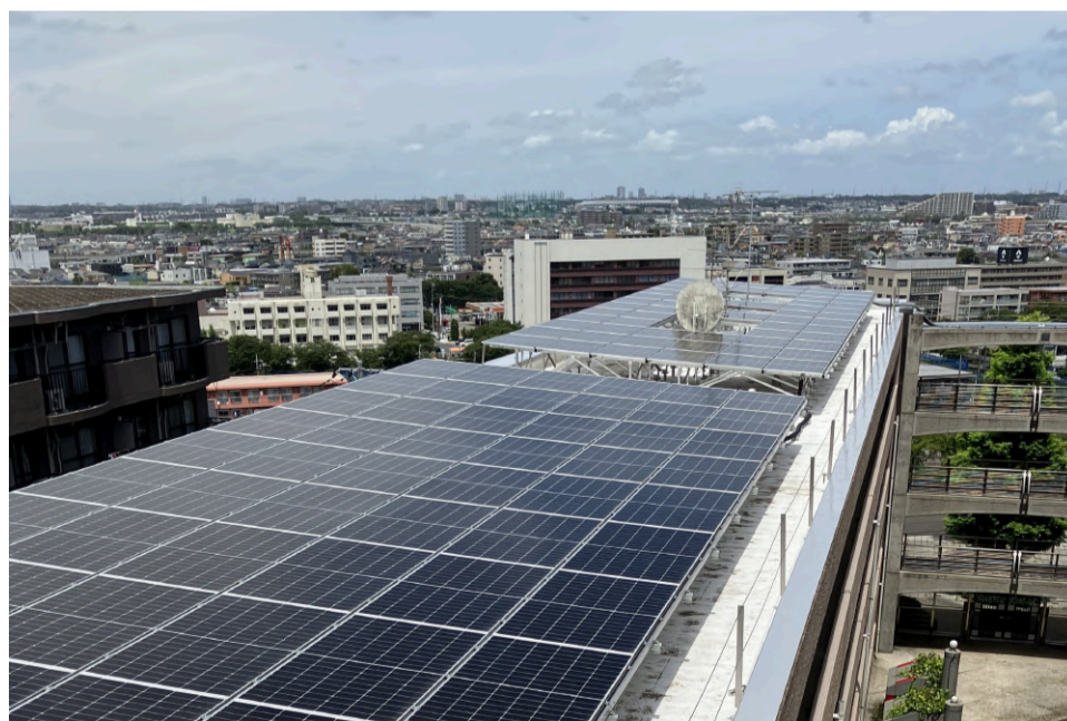
太陽光パネル
