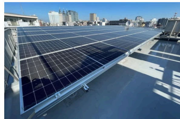
T's eco川崎 太陽光パネル
