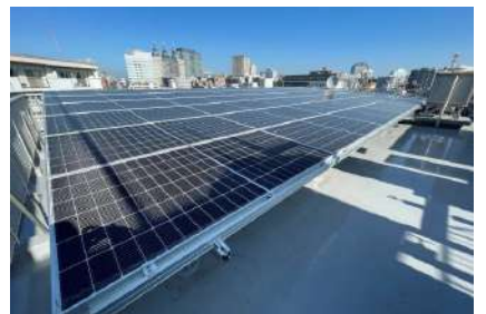
屋上に設置した太陽光パネル
