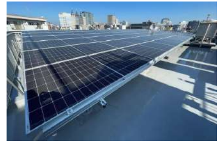
T's eco川崎 太陽光パネル
