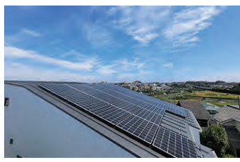
太陽光発電システム
