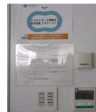
フロアの室温管理
