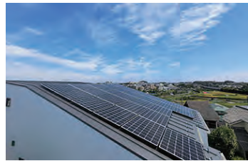
太陽光発電システム
